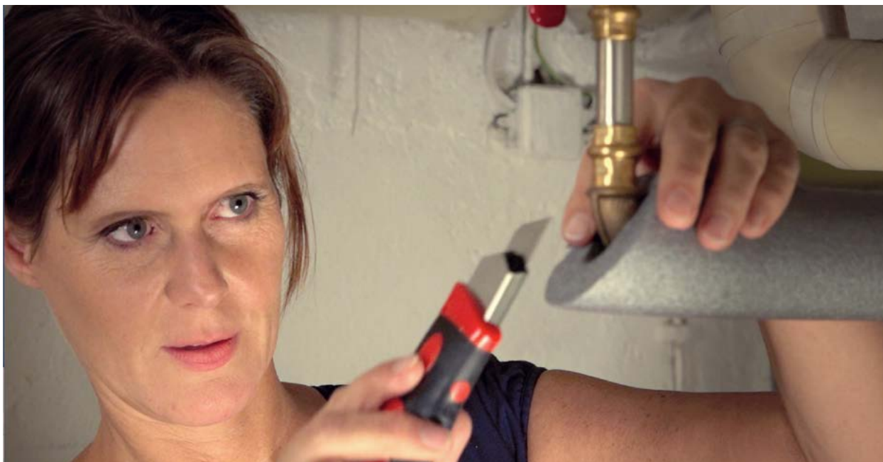
Ihre Heizungsrohre können Sie ganz einfach selbst dämmen. Die Arbeit macht sich schnell bezahlt.
