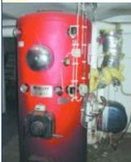
Heizung der 70er Jahre
