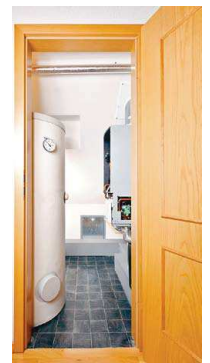
▲ Auch eine Umrüstung auf solare Heizungsunterstützung vorhandener Speicher ist manchmal möglich. Ein alter 400-Liter-Warmwasserspeicher dient nun als Pufferspeicher.
