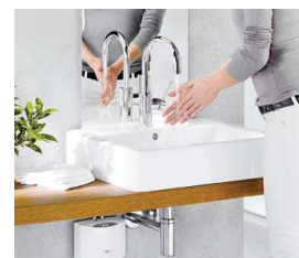
▲ Wenn es darum geht, kleine, abseits liegende Zapfstellen energiesparend und mit geringstem Aufwand mit Warmwasser zu versorgen, dann sind oft elektrische Durchlauferhitzer die erste Wahl.
