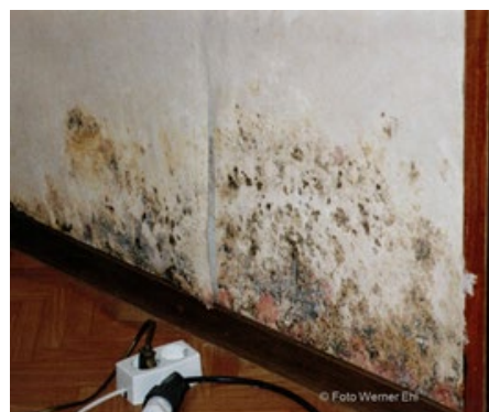
Abbildung 2: Schimmel am Sockel, Foto: Werner Ehl
