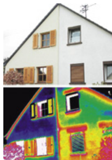
Die Thermografieaufnahme zeigt auf einen Blick, wo kostbare Energie verloren geht.
