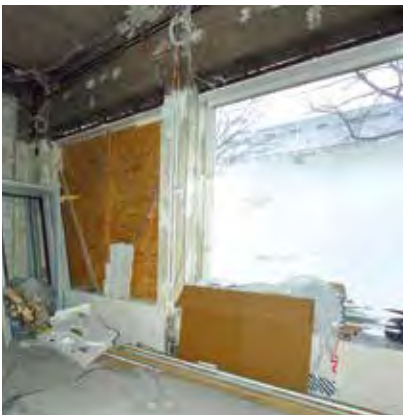
Durch die Schaufensterfronten konnte viel Wärme entweichen.
