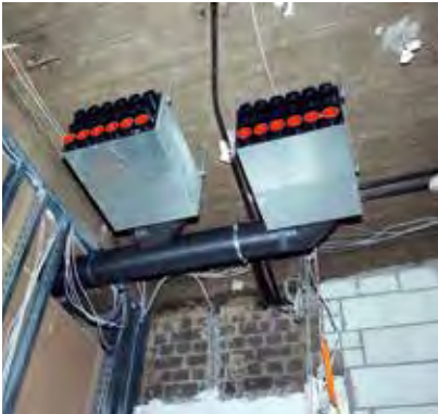
Kernstück des neuen Lüftungskonzeptes: Lüftungsanlage mit Wärmerückgewinnung.
