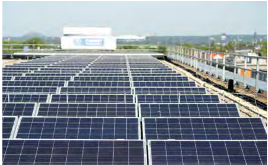
Solarkollektoren liefern Energie von der Sonne.
