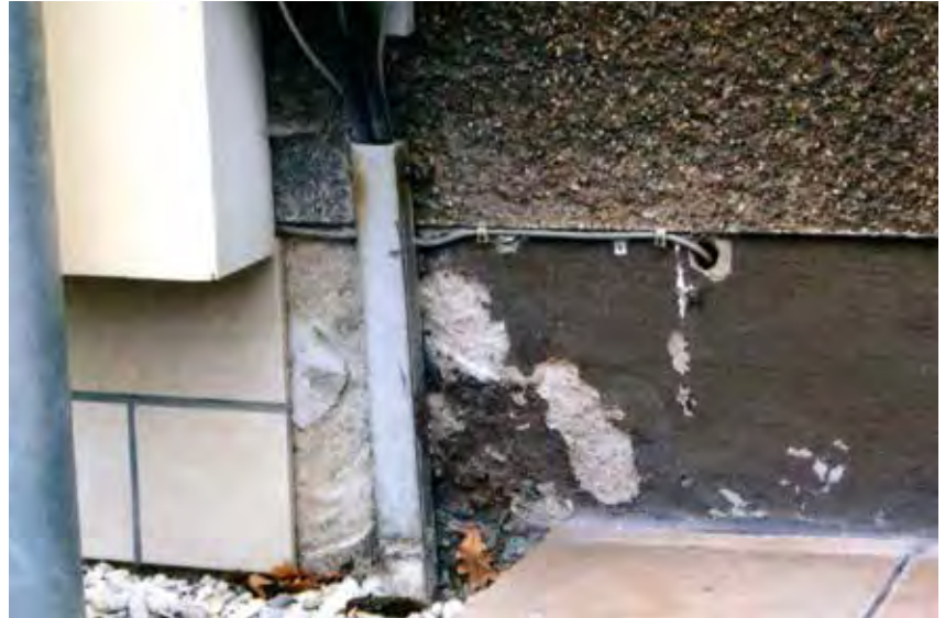
Sichtbar eindrucksvoll: der Unterschied zwischen gedämmter und ungedämmter Hausfassade.
