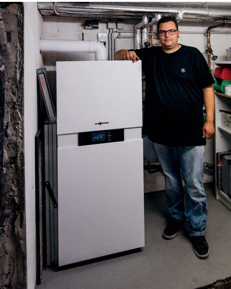
Eine neue Gasbrennwert-Therme hat den massiven Bergmannskessel im Keller abgelöst.
