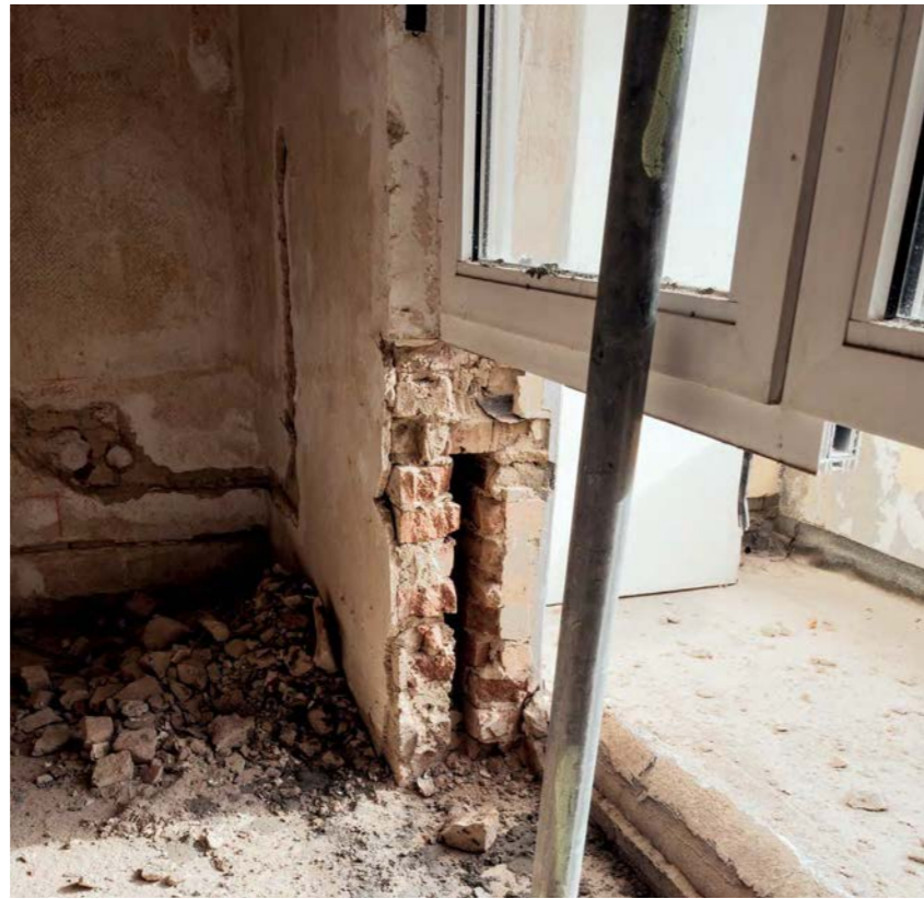
Die Hohlräume im doppelschaligen Mauerwerk können extrem kostengünstig mit eingeblasenen Materialien gedämmt werden.
