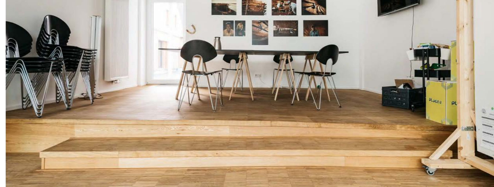
Wer genau hinguckt, dem bleibt die Schiefelage nicht verborgen. Das teilweise bis zur vier Prozent starke Gefälle wurde nicht mit der Wasserwaage, sondern mit psychologischem Einfühlungsvermögen ausgeglichen. Ganz grade ist es nirgends...
